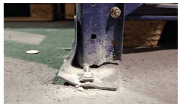
Daños en estanterías metálicas
